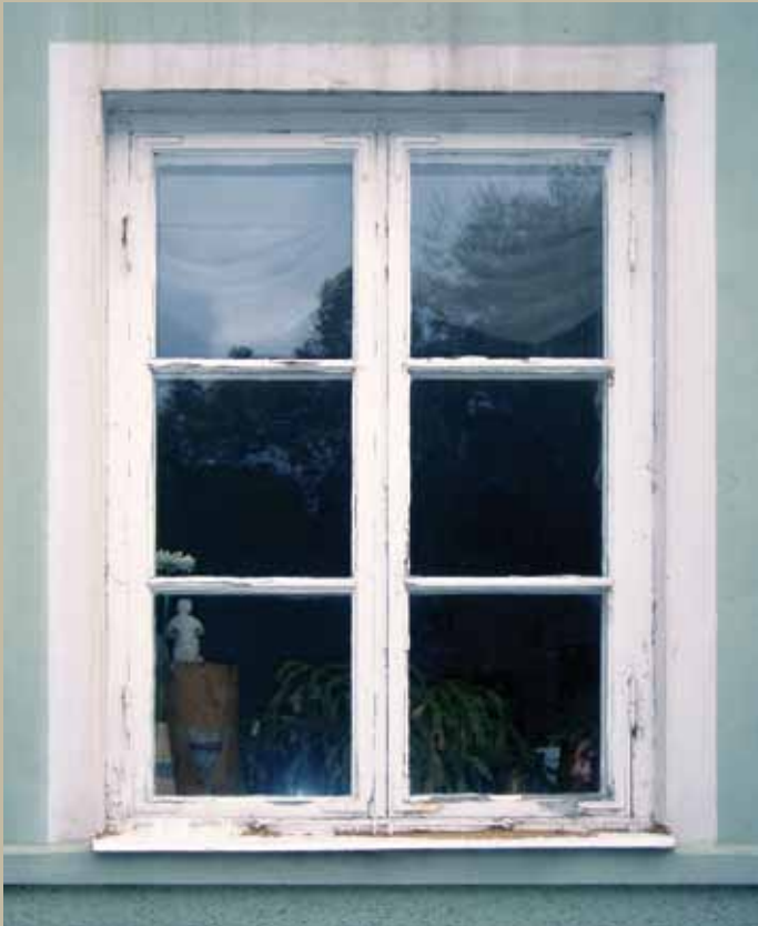
► Gammalt träfönster före fönsterbyte.
