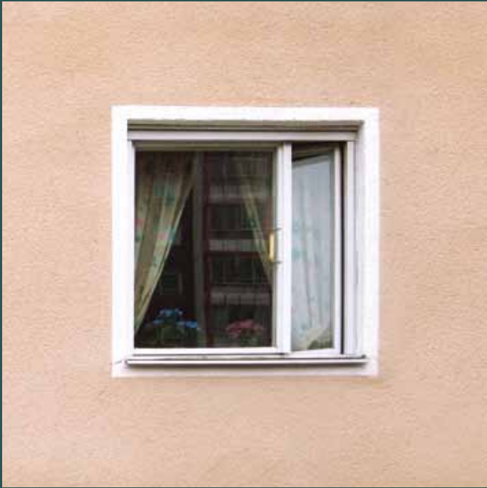
► Gammalt träfönster före fönsterbyte.
